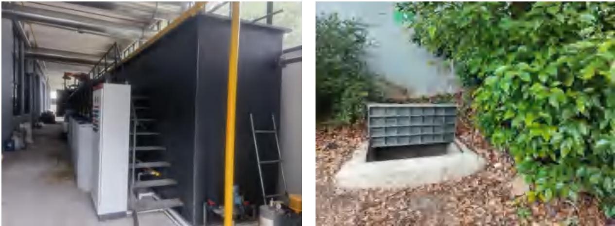
图 3-2 污水处理站/雨水池照片
