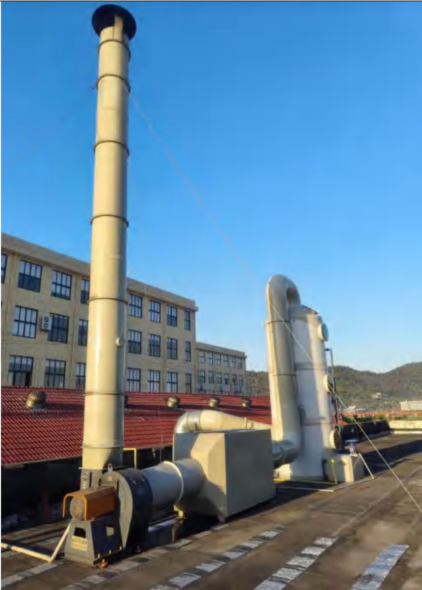
熔融、浇注废气废气处理设施（DA001）
