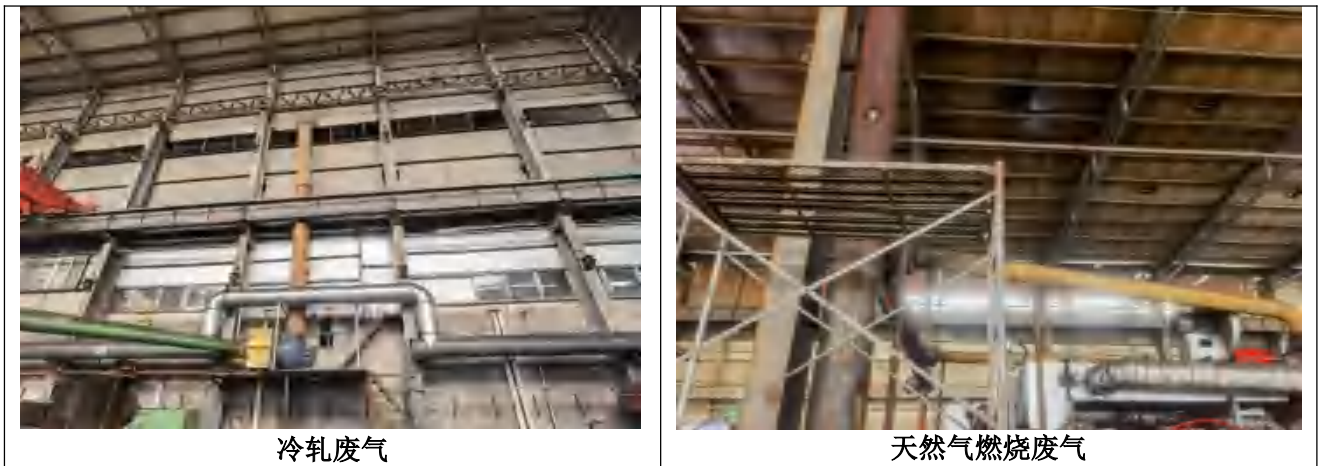
图 3-4 废气处理设施照片
