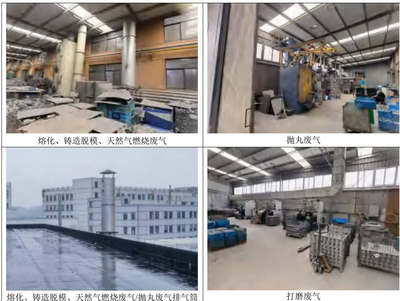
图 3-4 废气处理设施照片
