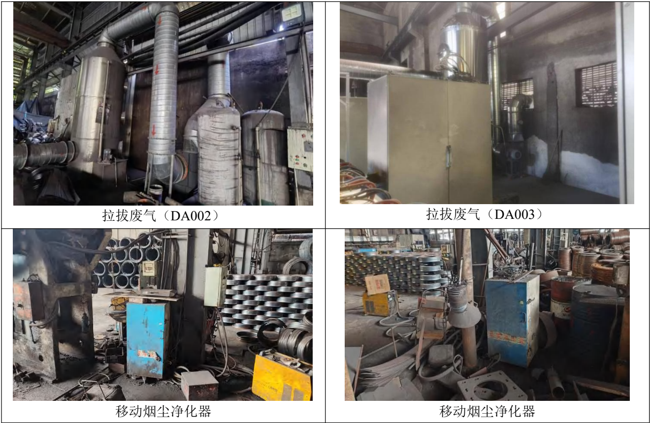
图 3-2 废气处理设施照片
