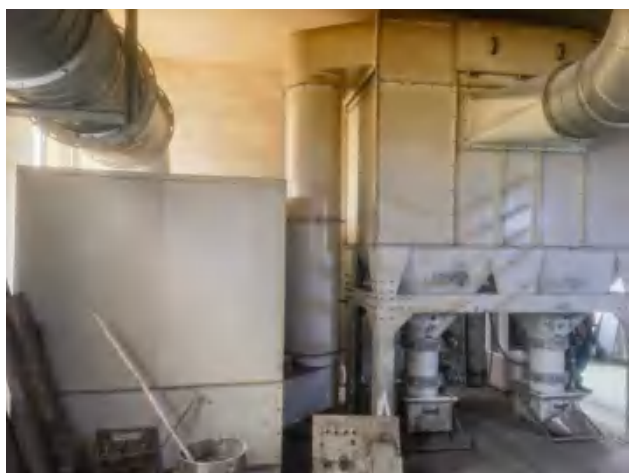
喷塑废气处理设施
