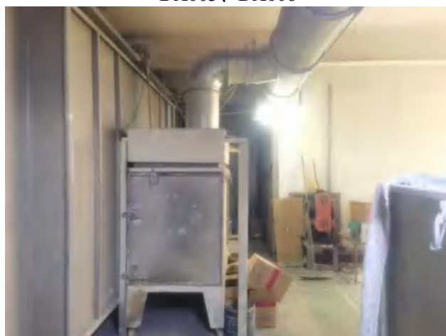
喷塑废气处理设施
