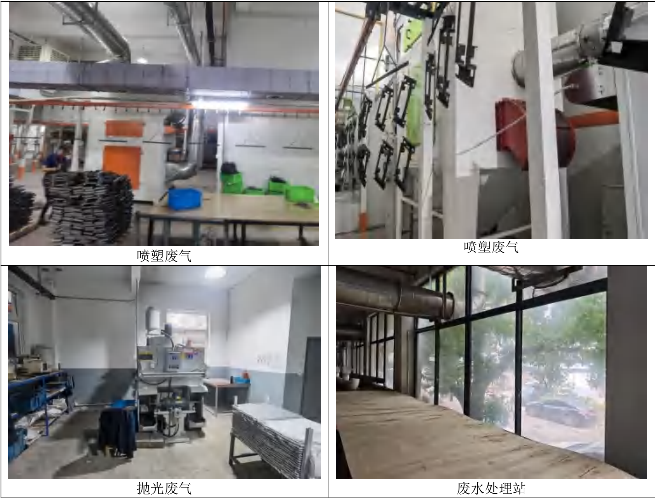
图 3-5 废气处理设施照片
