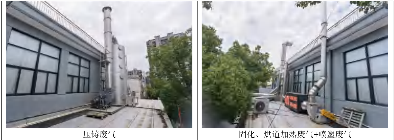
图 3-4 废气处理设施照片
