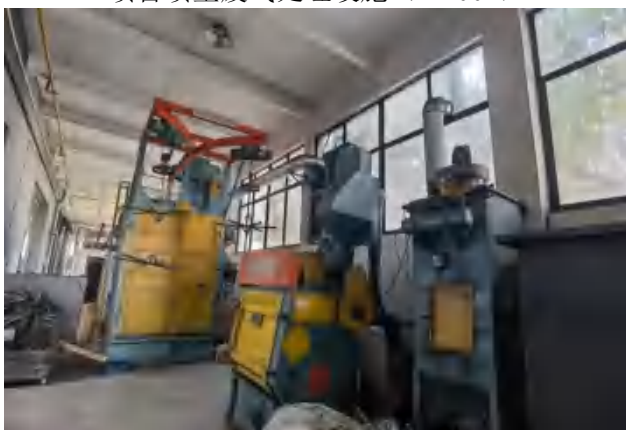
抛丸废气处理设施 (DA006)
