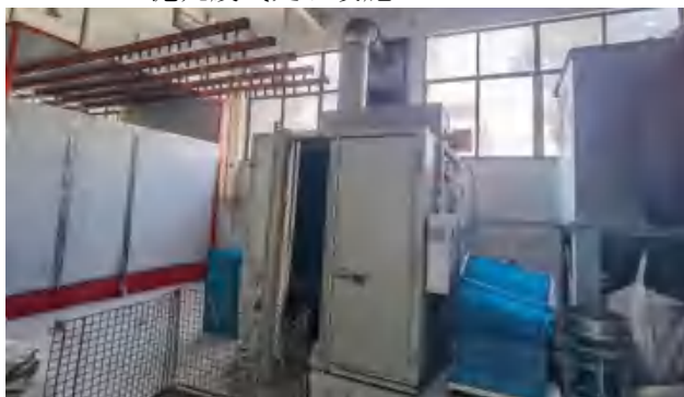
热洁炉废气 (DA007)
