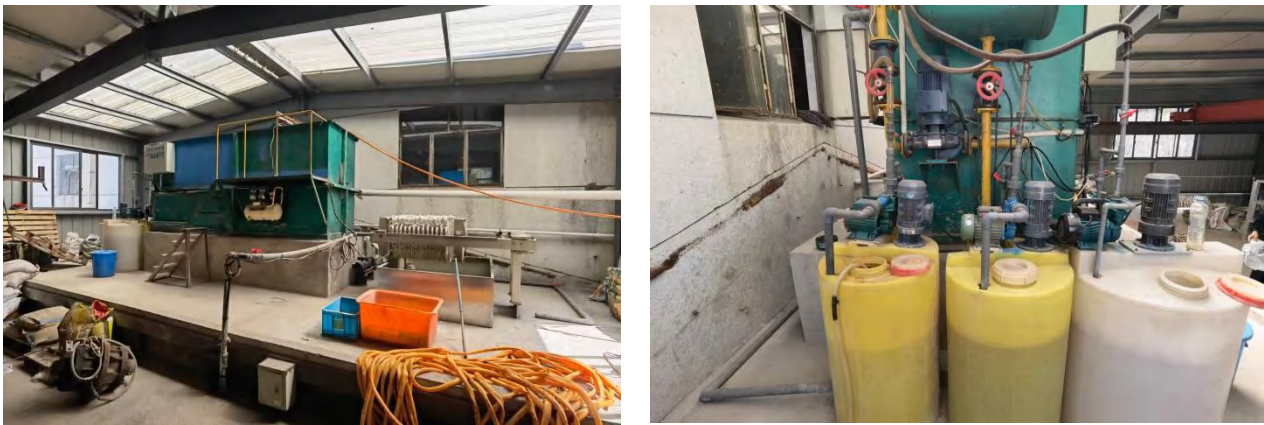
图 3-2 废水处理站照片
