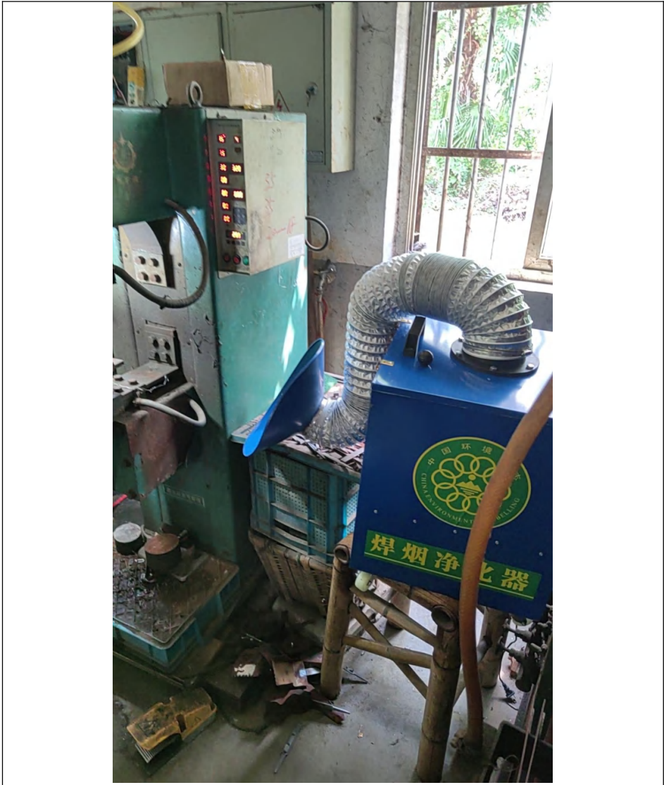
图 3-3 项目废气处理设施照片
