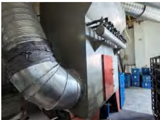
喷塑废气处理设施
