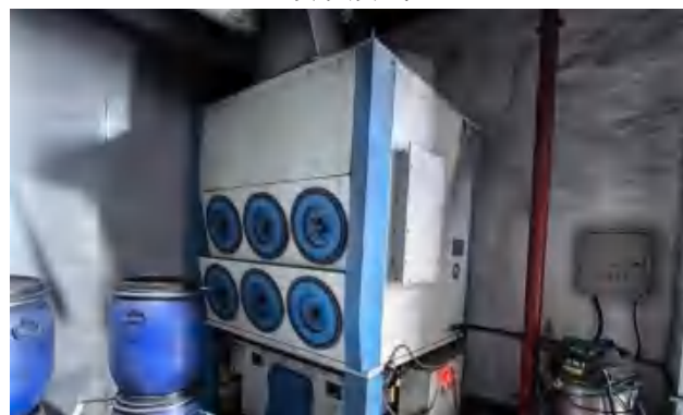
无组织废气处理设施
