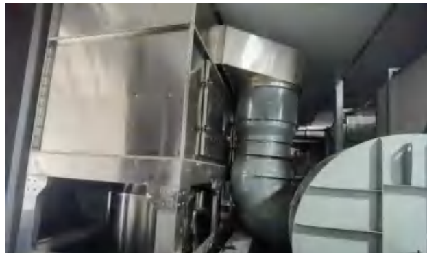
涂装废气处理设施
