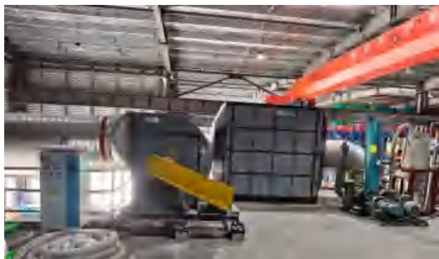
注塑废气处理设施
