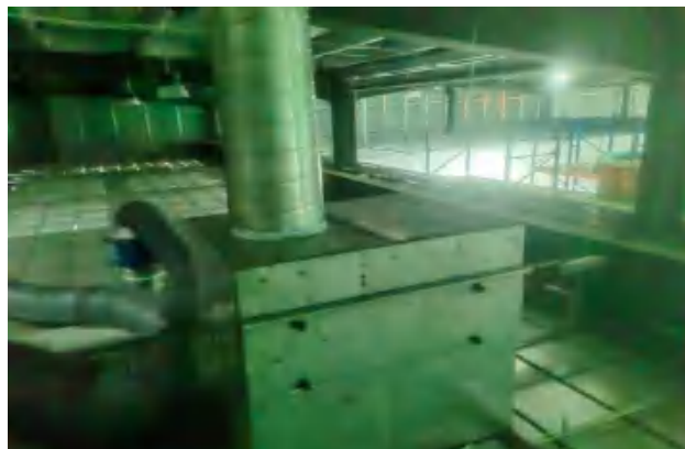
固化烘干废气处理设施
