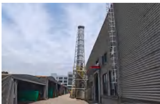
DA002 涂装废气处理设施
