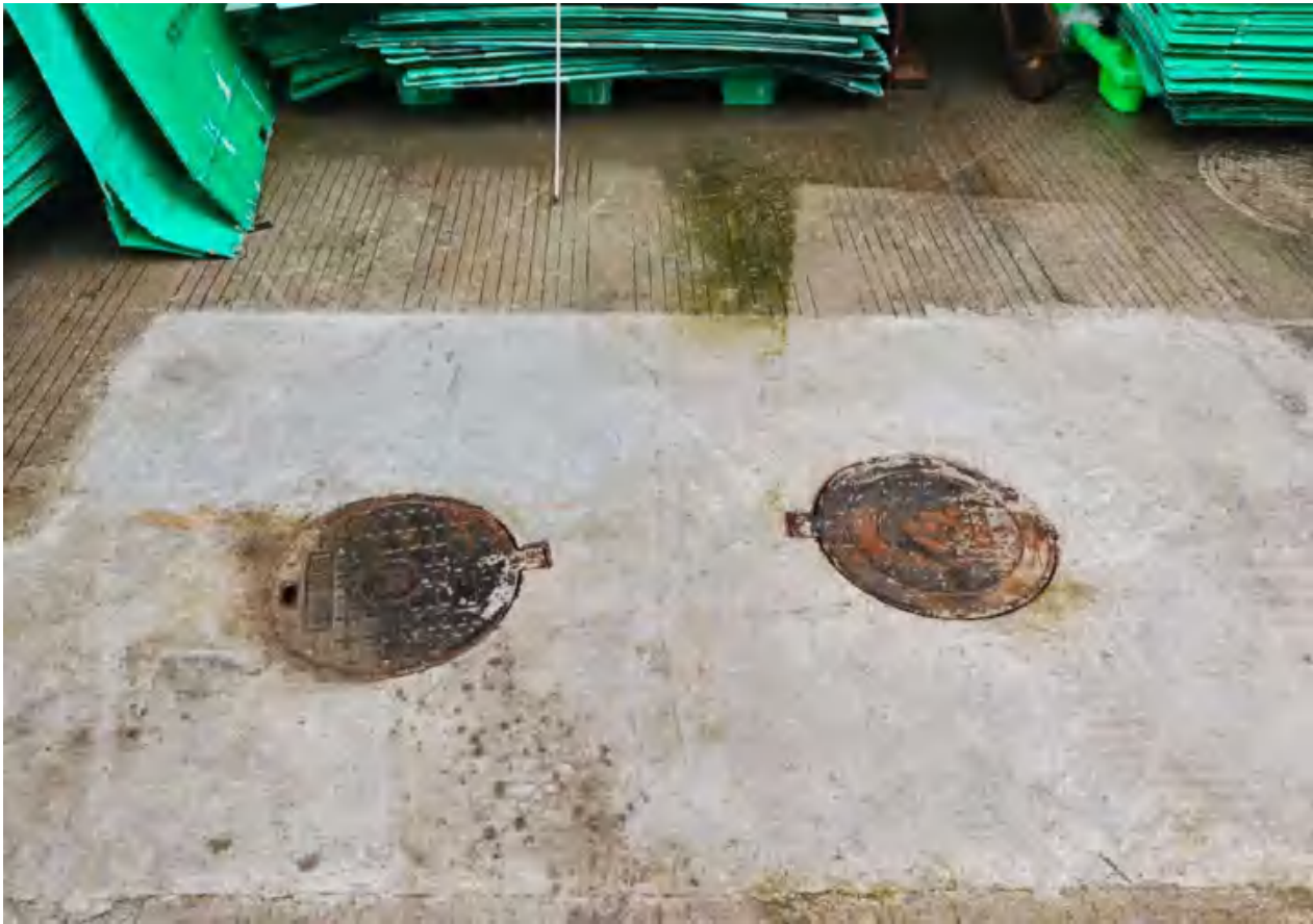
图 3-2 生活污水排放口照片
